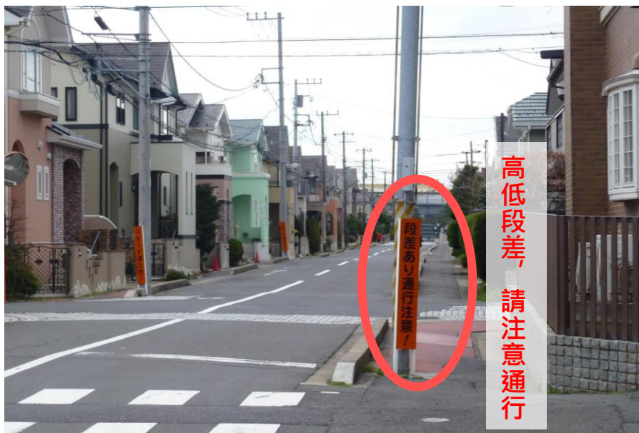
▼ 土壤液化造成1條道路有多處段差
