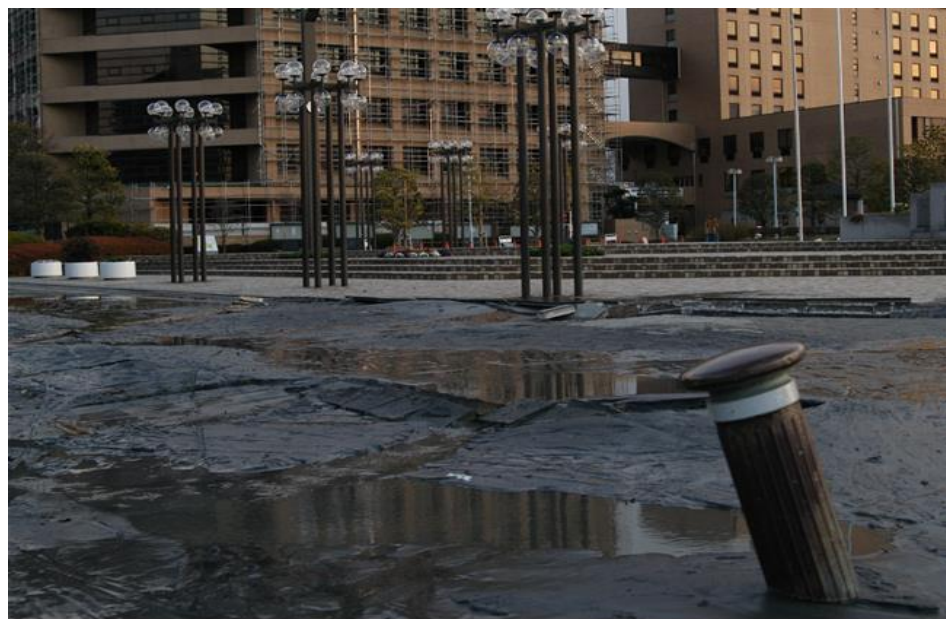
▼ 土壤液化造成地面滲水
